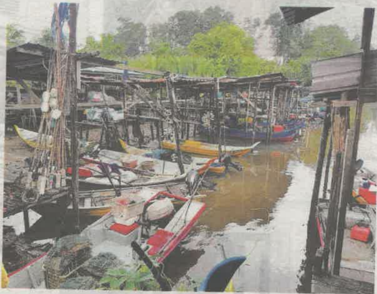
JETI nelayan di Sungai Che Rahmat, Trong dekat Taiping akan dibaik pulih kerana terlalu uzur dan tidak selamat digunakan.
